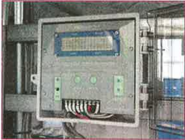
日射量制御盤
